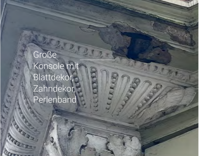
Abb. 8.4 Starke Beschädigung des Gesimses und der Konsole
