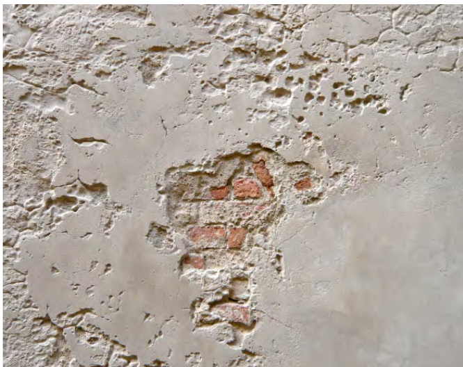
Abb. 7.12: Putzschäden durch Salzeinwirkungen
