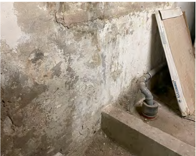
Abb. 2.2: Kellerraum Außenwand Frontfassade
