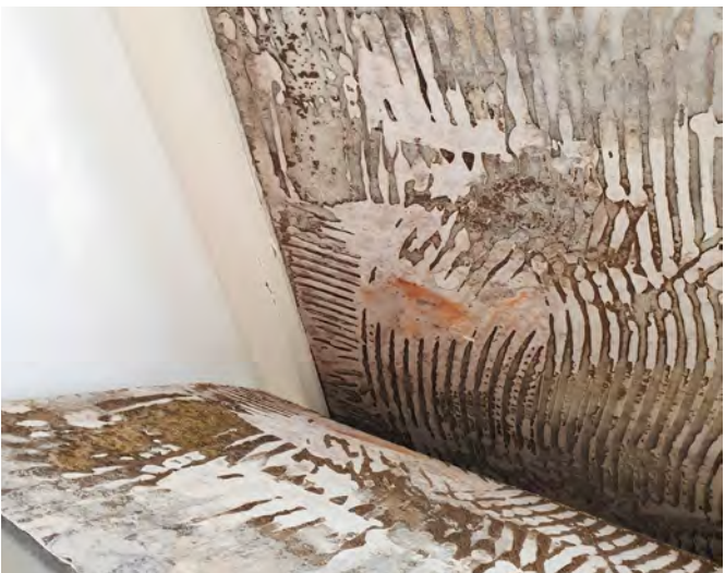
Abb. 13.11: Schimmel zwischen Außenwand und Dämmschicht
