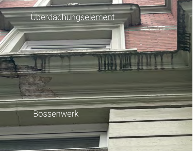
Abb. 8.6 Abgeblätterter Anstrich und Algenbewuchs
