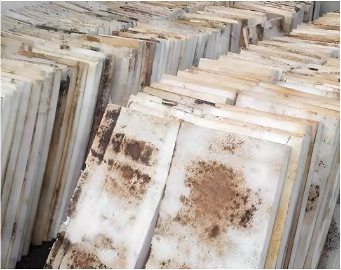
Abb. 13.5: Feuchteschäden an abmontierten Dämmplatten
