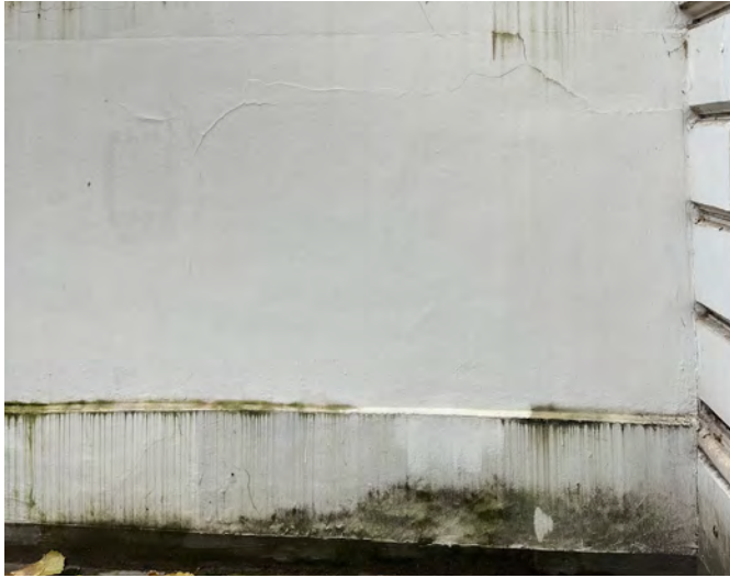
Abb. 7.7: Salzausblühungen im Sockelbereich
