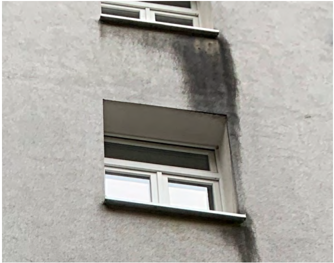
Abb. 15.9: Wasserschaden an der Putzfassade aufgrund der Fensterbank
