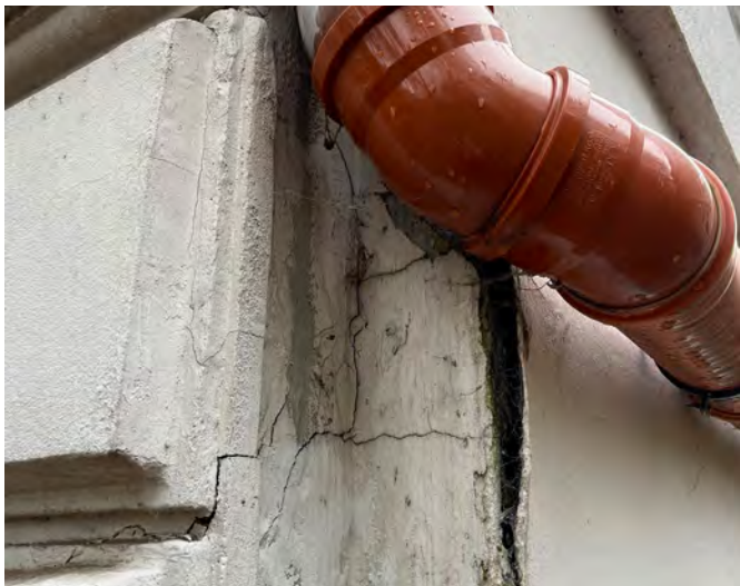
Abb. 7.8: Risse und Putzabplatzungen am Wasserabfluss
