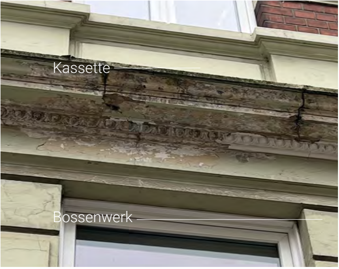
Abb. 8.2 Abplatzungen Gesimse und Perlenband, Risse im Gesims
