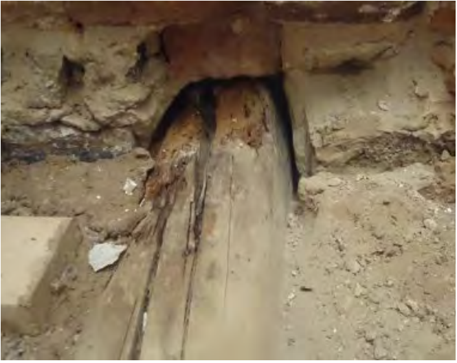
Abb. 11.2: Feuchteschaden an Holzbalken im Mauerwerk
