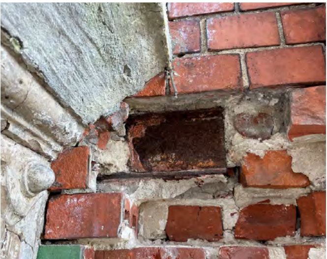
Abb. 9.6: Unterlagsträger, Korrosion an Steg und Flanschen
