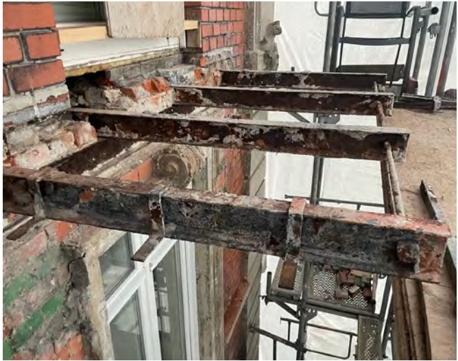
Abb. 9.9: freigelegte, aufliegende IPN-Träger
