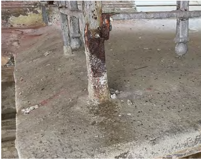
Abb. 10.3: Korrosionsschäden am Geländer
