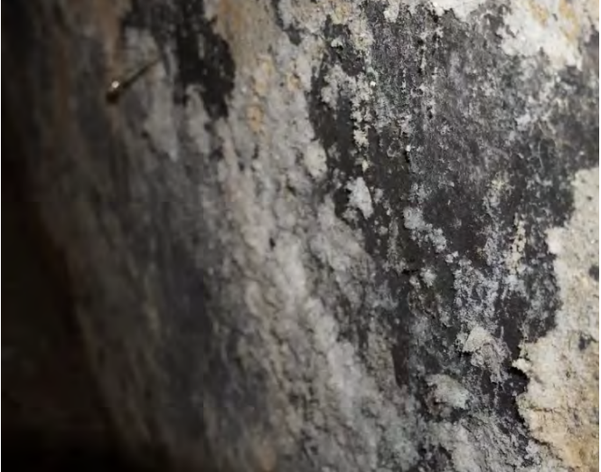
Abb. 4.12: Salzausblühungen am Mauerwerk
