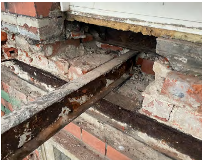
Abb. 10.5: Korrosionsschäden am Unterlagsträger und Doppel-T-Träger
