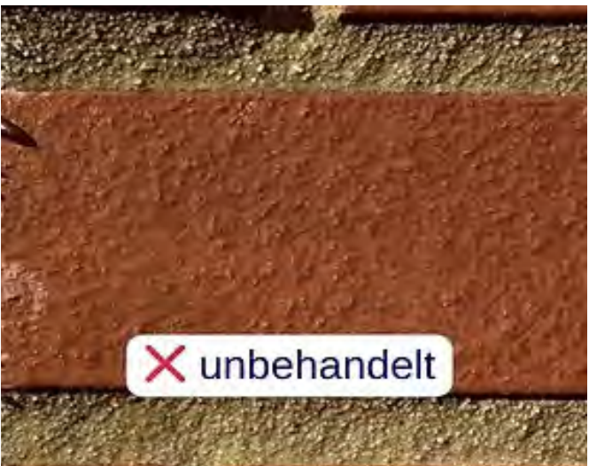
Abb. 5.17: Vormauerwerk ohne Imprägnierung
