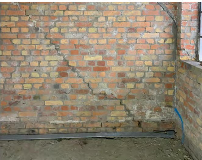
Abb. 6.32: Getreppter Riss und Zugband
