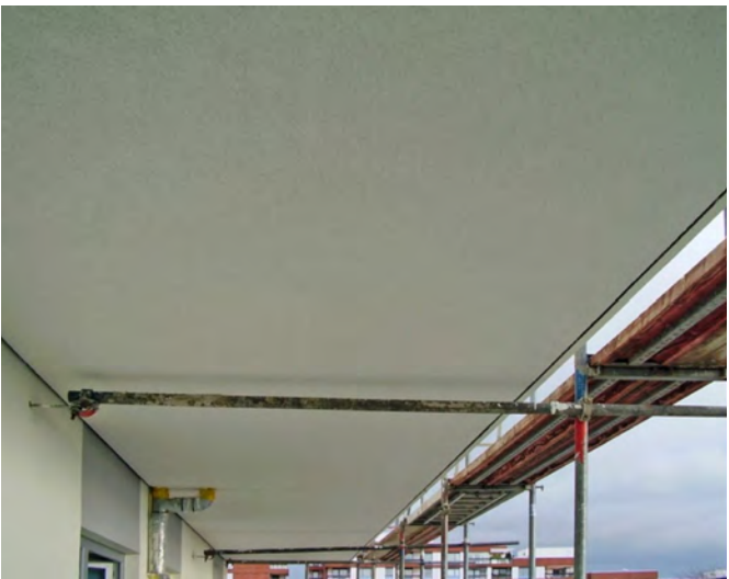
Abb. 9.16: Untersicht Balkon mit abgehängten Putzträgerplatten
