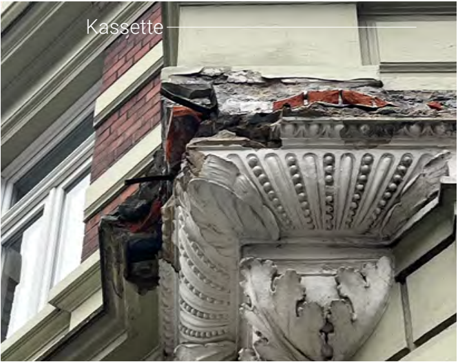
Abb. 8.3 Massive Schäden des Gesimses
