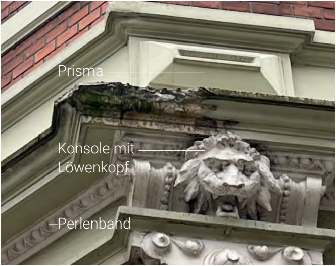
Abb. 8.5 Abgebrochene Teile des Gesimses mit Algenbewuchs
