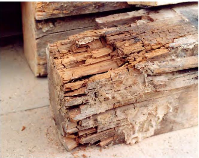
Abb. 11.6: Balkenkopf mit Hausschwamm-Befall
