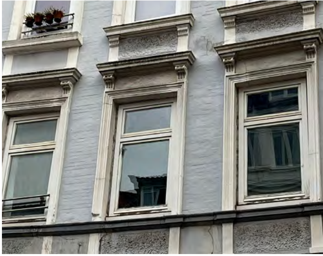
Abb. 7.4: Bellealliancestrasse Gloria: weites Rissbild in der Fassade
