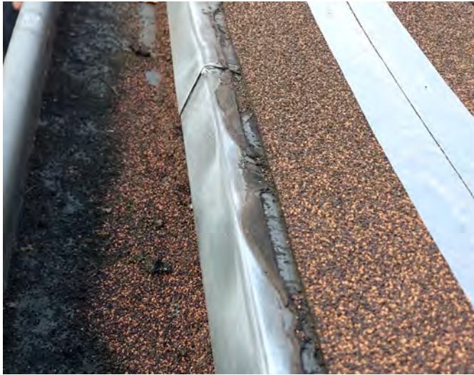
Abb. 17.9: Anschluss ohne Strangpressprofil wird undicht
