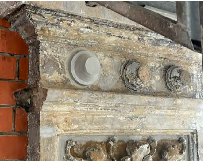
Abb. 8.9 Abgebrochene Teile werden mit Hilfe von Abdrücken nachgebildet
