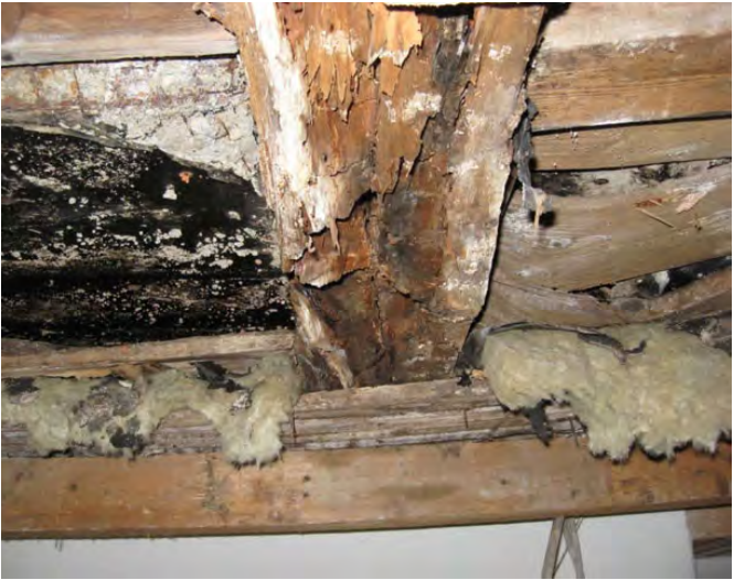
Abb. 11.3: Balkendecke mit Feuchteschaden
